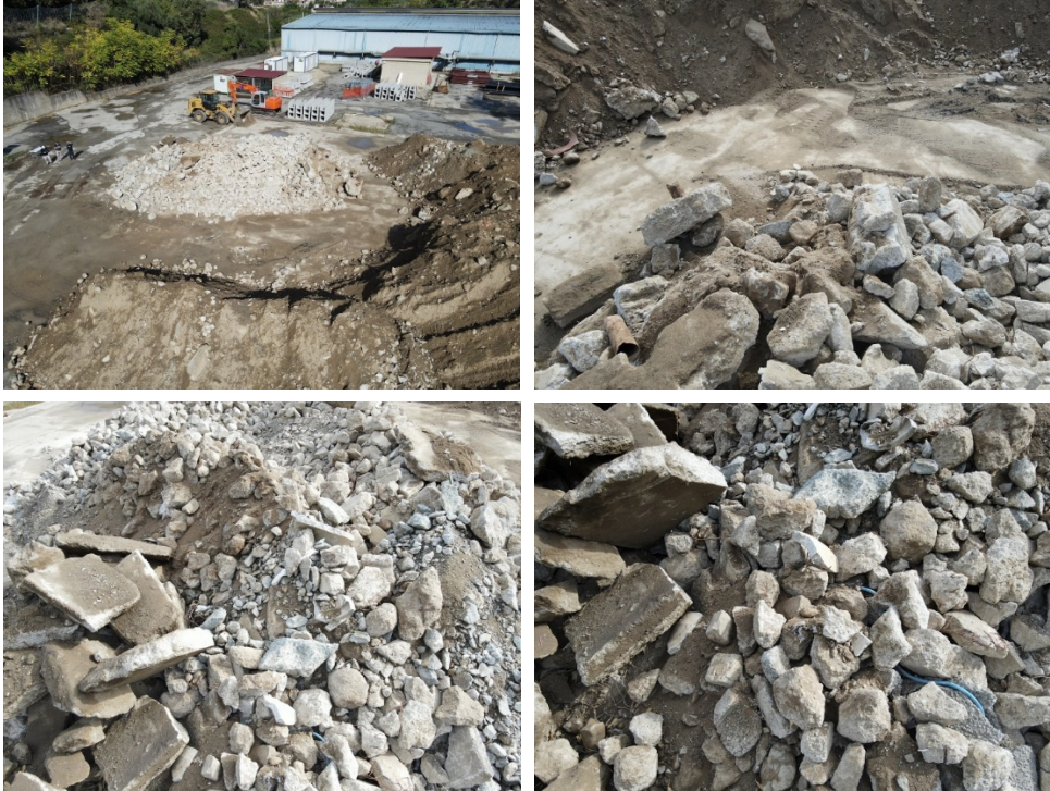
Figura 6: Macerie di demolizione sotto osservazione
