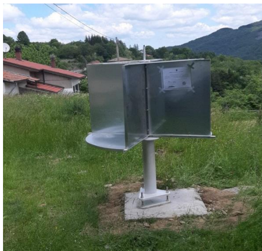
Figura 13 – Riflettore artificiale installato. Fonte: archivio UniFI
