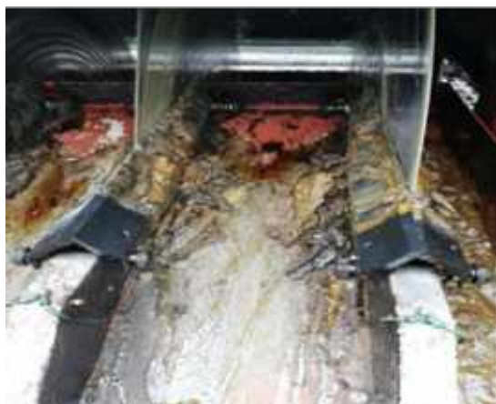
Figura 45. Discoil di sinistra poco efficiente nella separazione oli
