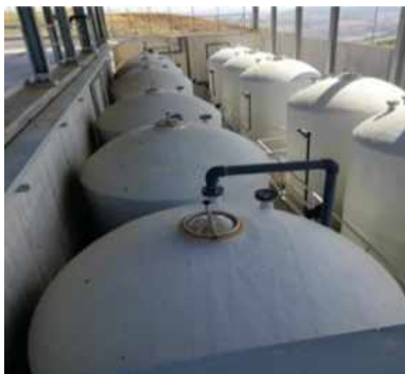
Figura 25. Silos di stoccaggio del percolato
