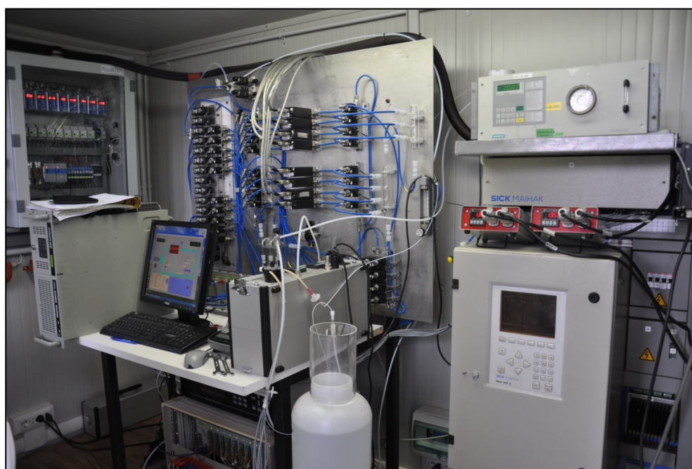
Figura 3 – Impianto LOOP: l'interno del box di controllo e generazione miscela campione
