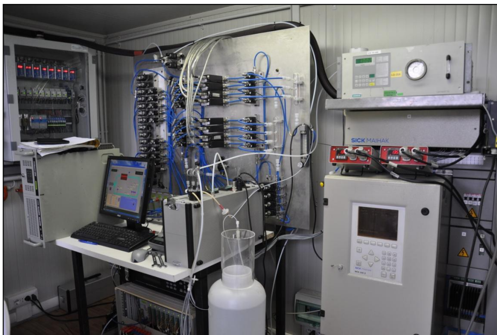
Figura 3 – Impianto LOOP: l'interno del box di controllo e generazione miscele campione
